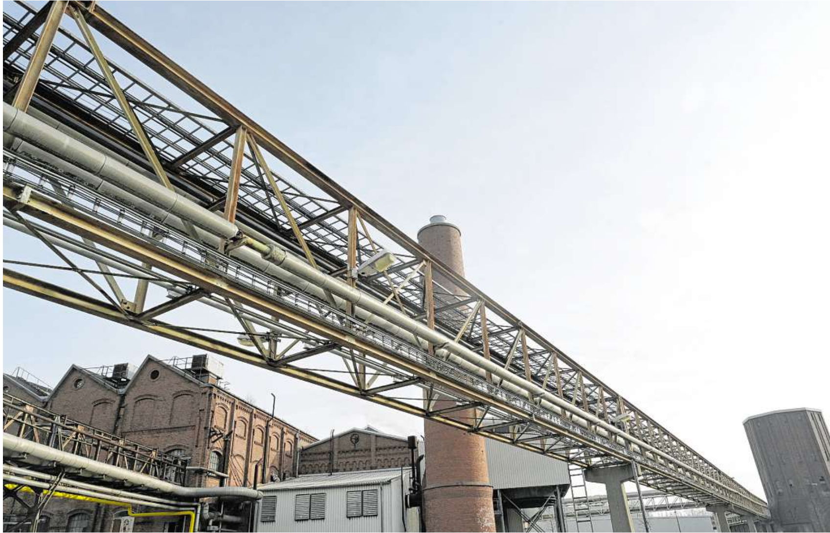
Das Kraftwerk im Kämmerlei-Quartier: Der Betreiber will Millionen Euro in den Standort investieren – und mithilfe eines Partners das Leitungsnetz ausbauen. FOTOS: CARMEN JASPERSEN
